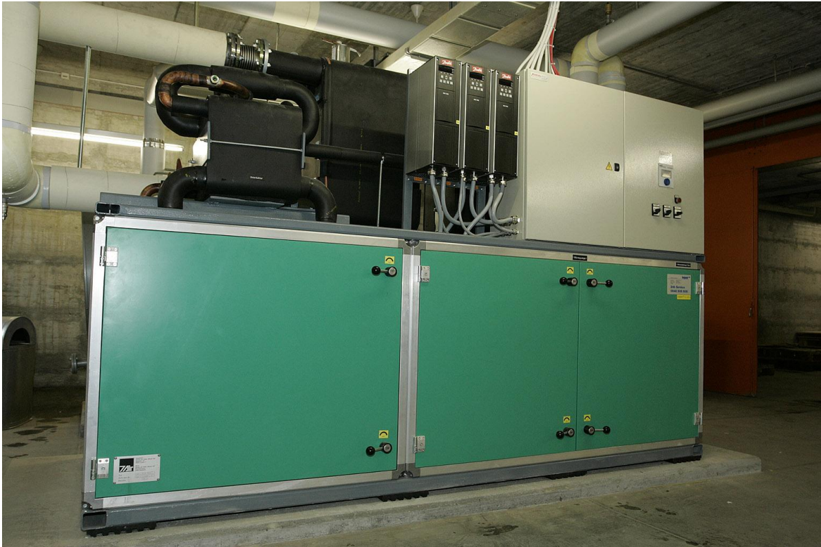
Bild 3: FEKA-Wärmepumpe für eine ganzjährige Warmwasseraufbereitung
